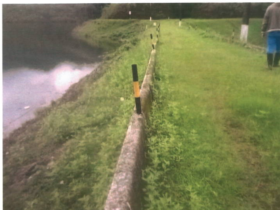
Figura 8: Desalinhamento do meio fio
