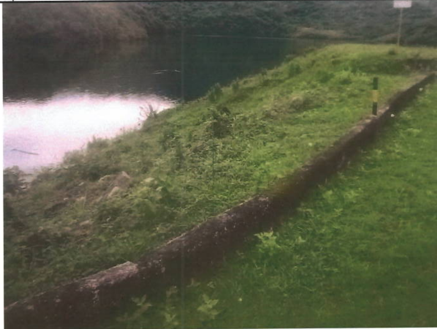
Figura 21: Ombreira esquerda a montante
