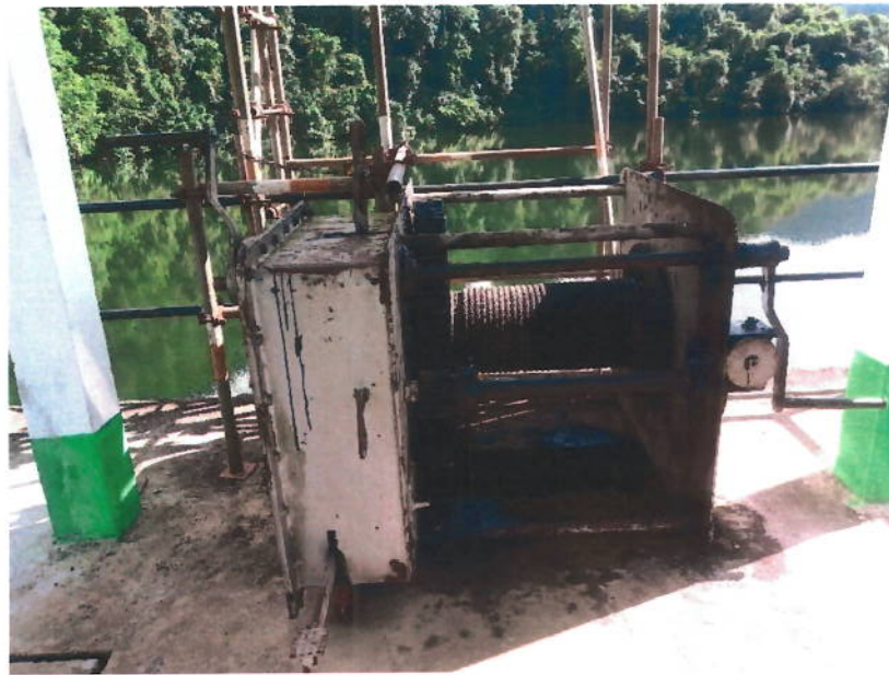
Figura 33: Equipamento de operação das comportas
