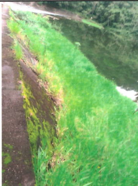
Figura 29: Muro com vegetação e desgaste
