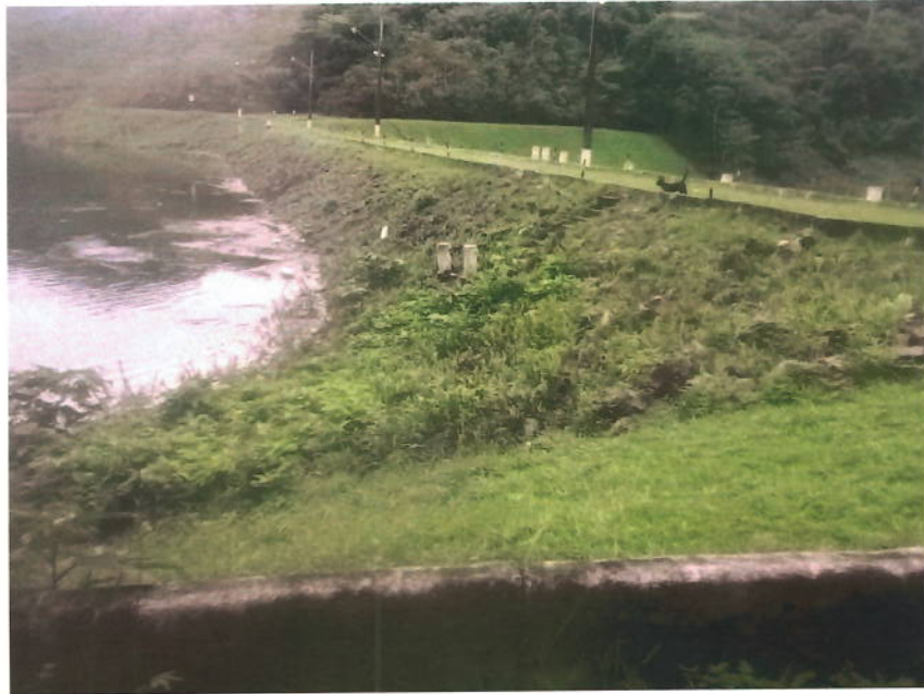
Figura 9: Vegetação no talude
