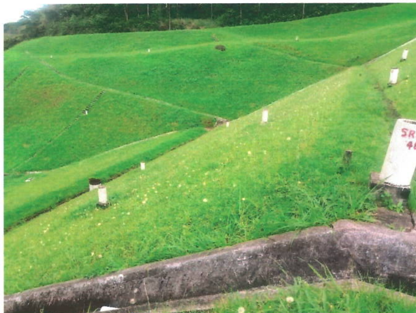
Figura 20: Ombreira direita a jusante
