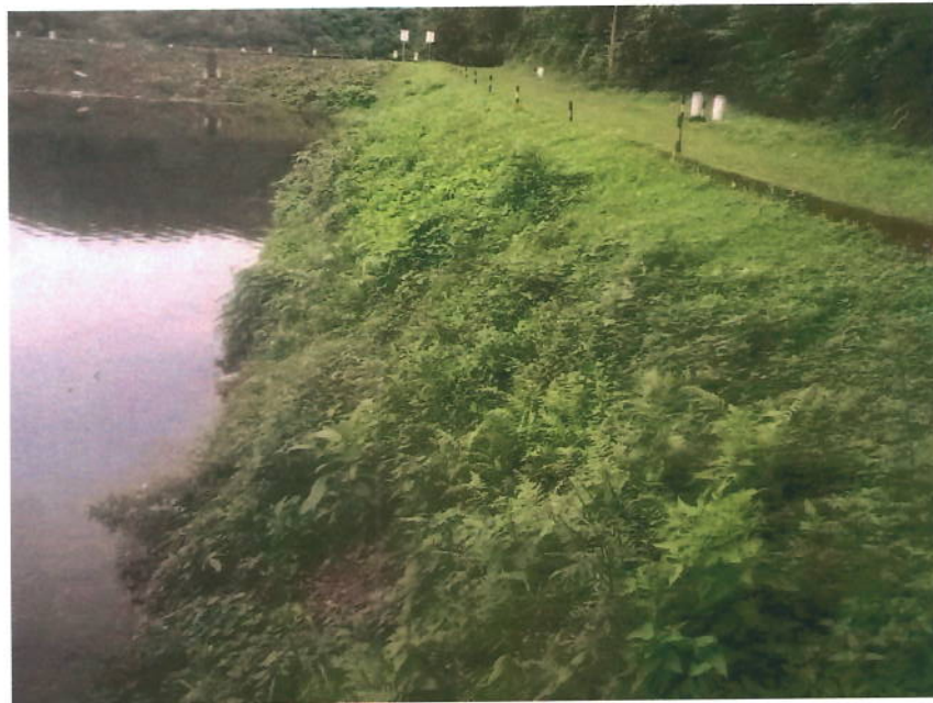
Figura 10: Presença de arbustos no talude6
